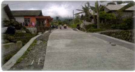
Drainase dan dinding penahan di Desa Jrasah
